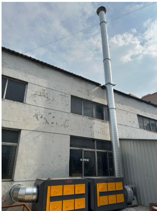
图 4.1-1 注塑废气两级活性炭吸附装置及排气筒
