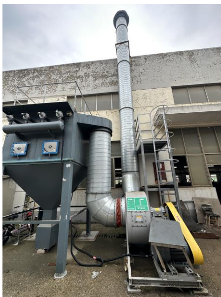
图 4.1-1 滤筒除尘装置 (TA001) 及排气筒 (DA001)
