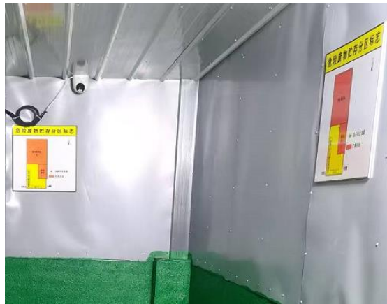
图 4.6.1-3 危险废物贮存设施分区牌现状图
