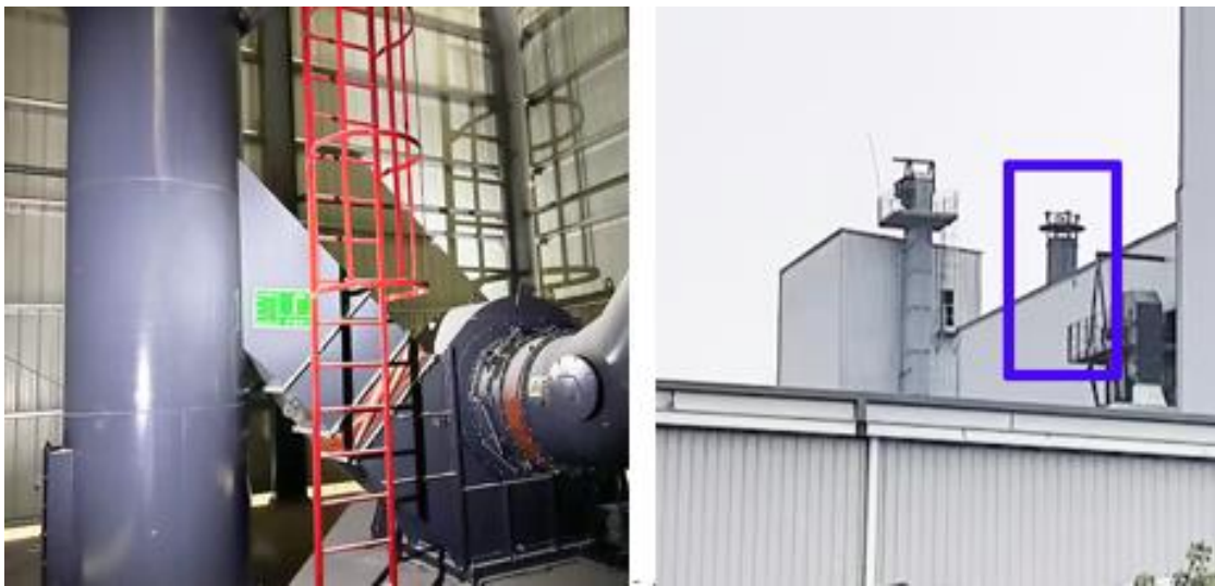
图 4.1-1 破碎、筛分废气排气筒 DA001
