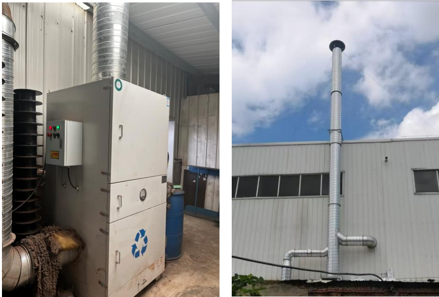
图 4.1-1 激光切割废气滤筒除尘装置及排气筒
