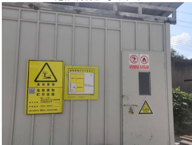
危险废物贮存设施标志牌
