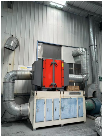
废气处理装置（TA001）及排气筒（DA001）
