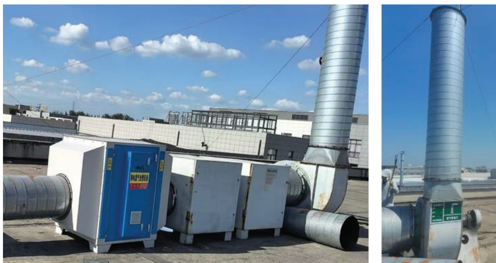
图 4.1-1 粘胶、泡胶废气处理装置 TA001 及排气筒 DA001
