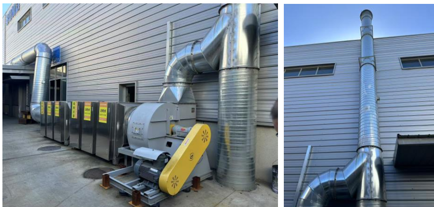
图 4.1-2 喷漆、晾干废气“滤棉过滤+两级活性炭吸附”装置及排气筒
