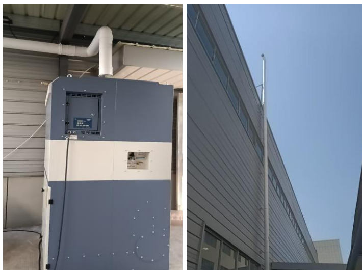
图 4.1-1 激光切割废气滤筒除尘装置及排气筒
