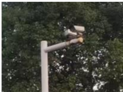
危废库外摄像头
