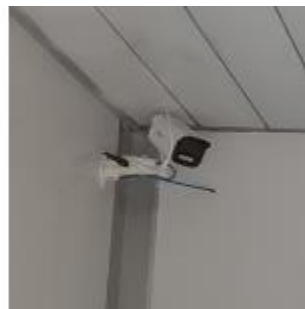
危废库内摄像头
