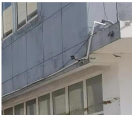
厂区门口摄像头
