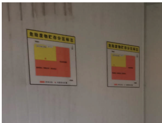
图 4.6.1-3 危险废物贮存设施内部分区警示标志牌现状图
