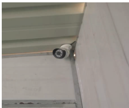
危废库内摄像头
