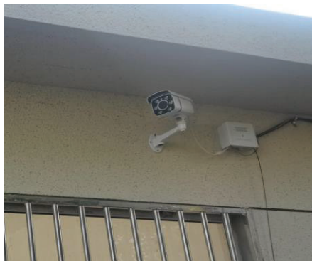
厂区门口摄像头
