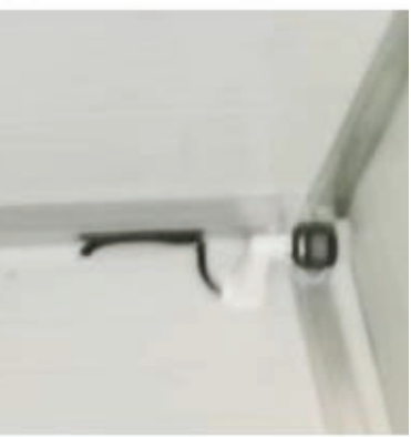
危废库内摄像头
