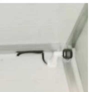
危废库内摄像头
