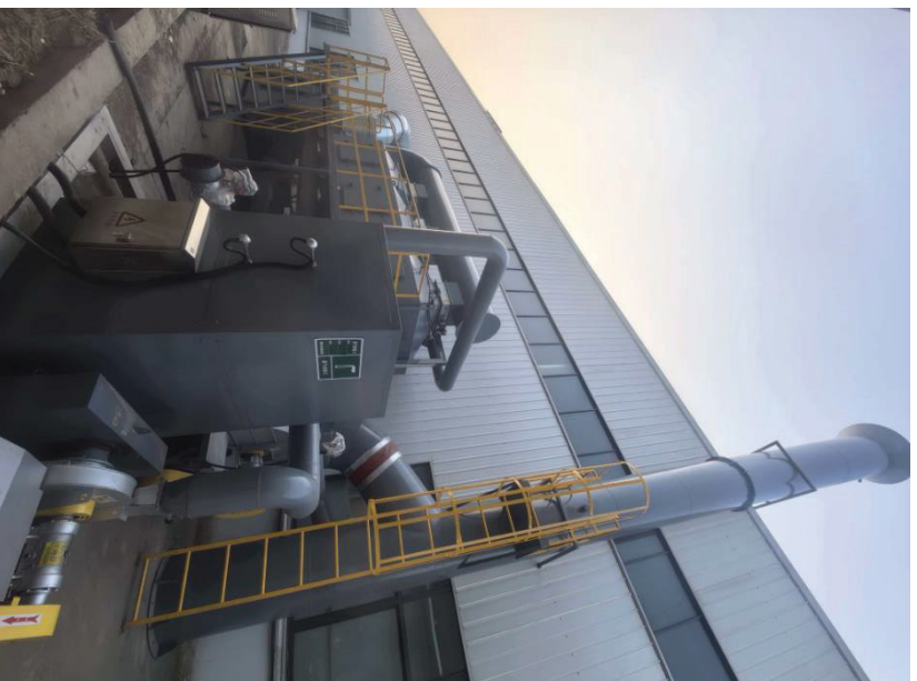
图 4.1-1 混料、拉挤成型废气处理装置 TA001 及排气筒 DA001
