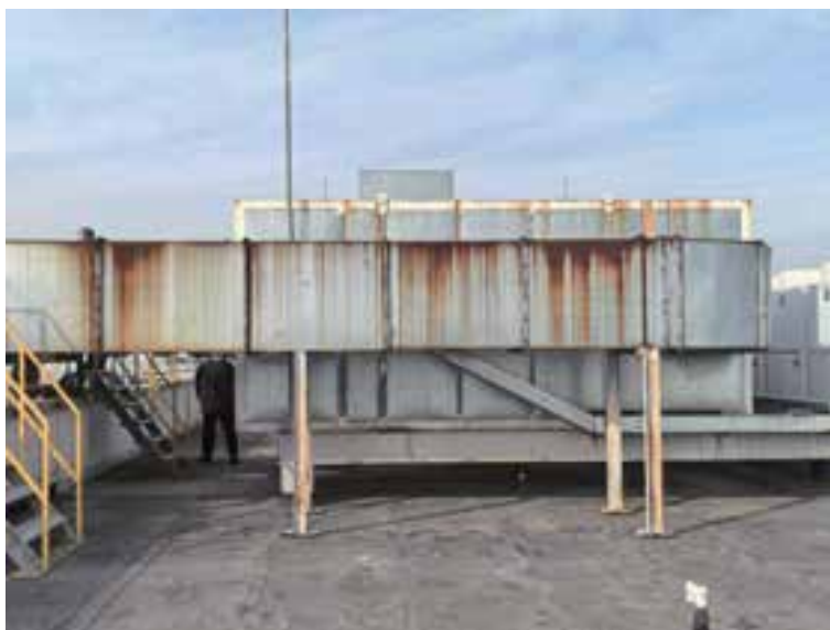
图 4.1-2 焊接废气处理（TA002）装置
