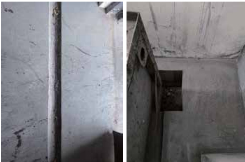
图 4.7.1-4 导流槽、收集孔
