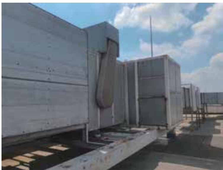
图 4.1-1 焊接废气处理（TA001）装置
