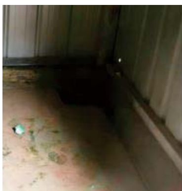
收集坑、导流槽
