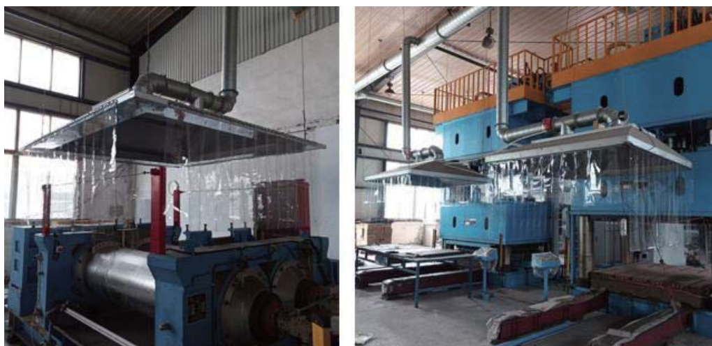
图 4.1-1 出片、硫化废气收集方式（集气罩+帘子）
