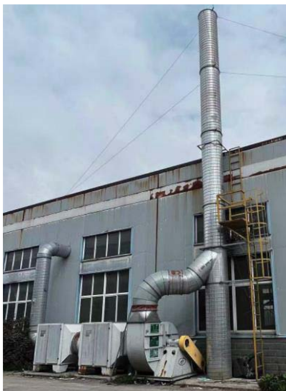
图 4.1-2 出片、硫化废气处理装置 TA001 及排气筒 DA001
