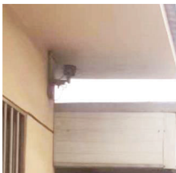
厂区大门口摄像头
