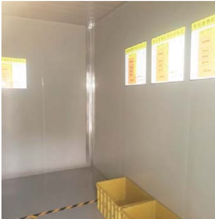
图 2-3 危险废物贮存设施分区牌现状图
