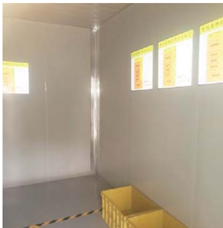
图 4.6.1-3 危险废物贮存分区标志牌现状图
