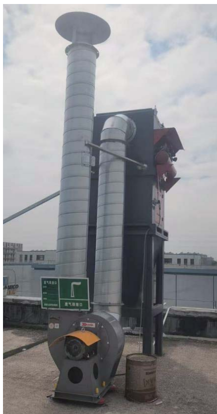
图 4.1-2 撕碎、破碎废气处理装置 TA002 及排气筒 DA002（位于楼顶）
