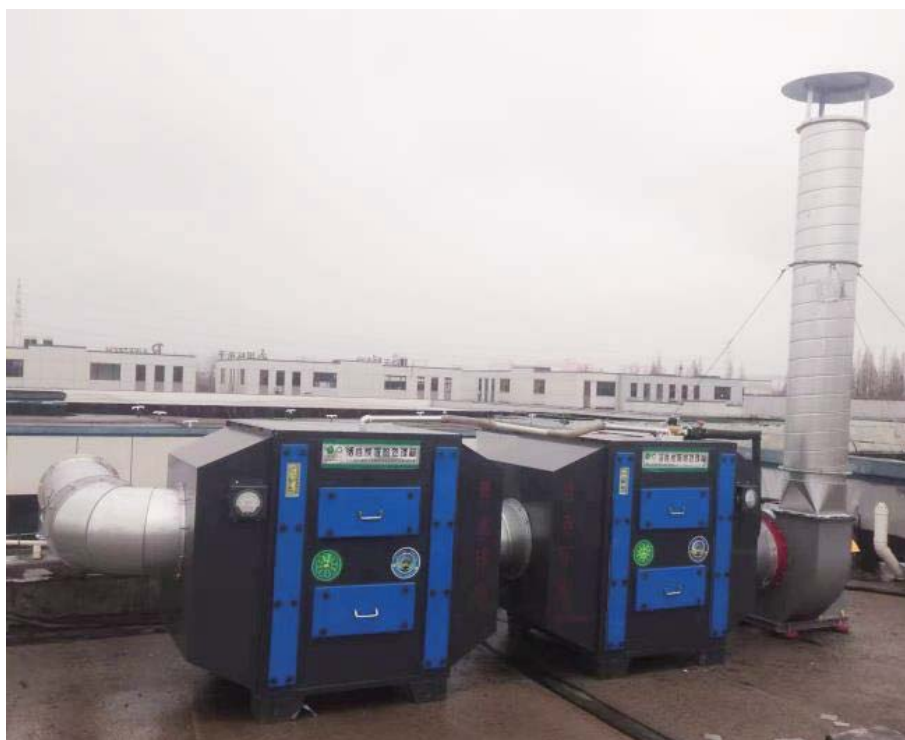
图 4.1-1 吹塑废气处理装置 TA001 及排气筒 DA001（位于楼顶）
