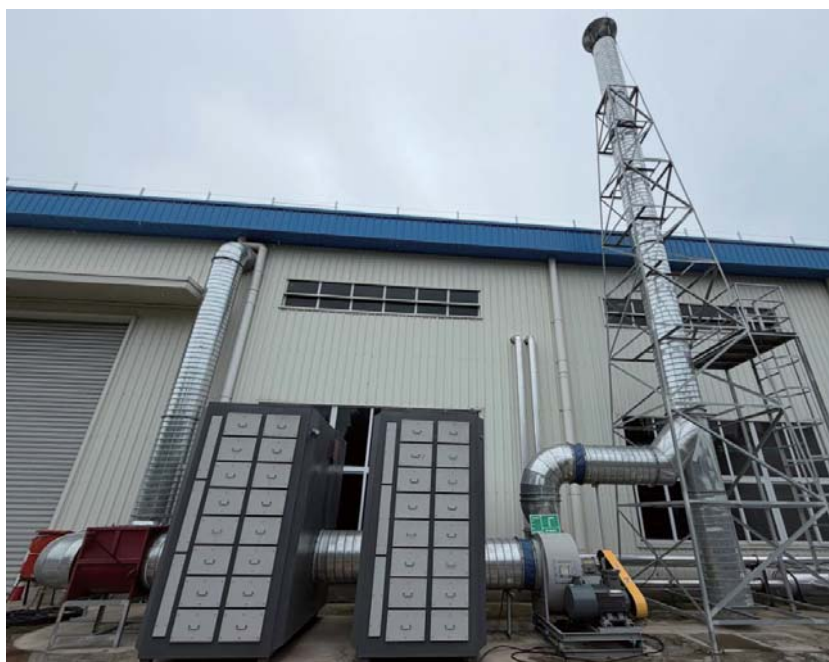
图 4.1-1 印刷、烘干废气处理装置 TA011 及排气筒 DA011
