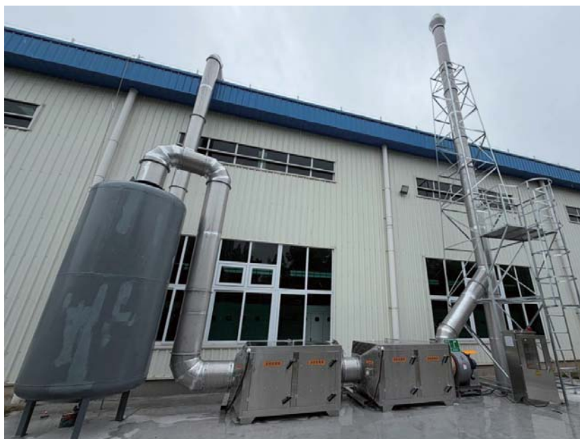
图 4.1-2 压合废气处理装置 TA012 及排气筒 DA012
