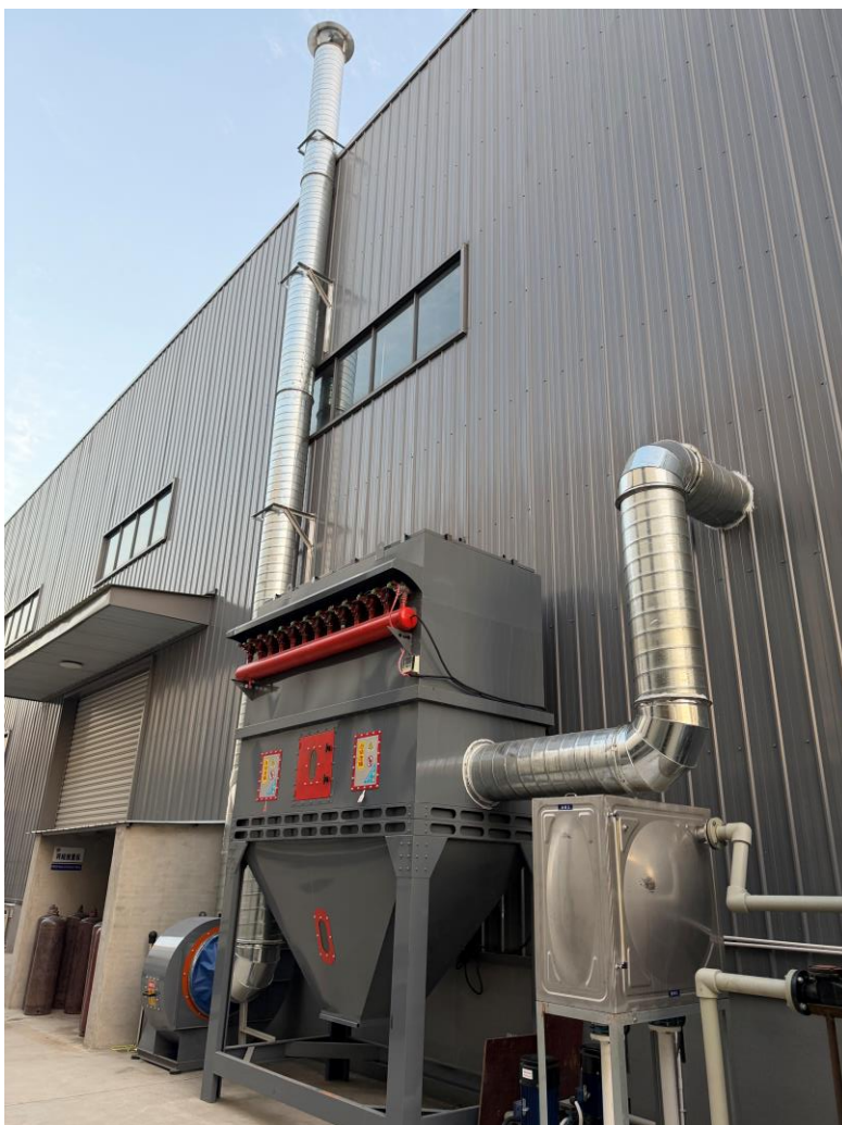
图 4.1-1 布袋除尘装置及排气筒
