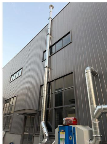
废气排气筒 (DA002)
