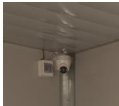
危废库内摄像头
