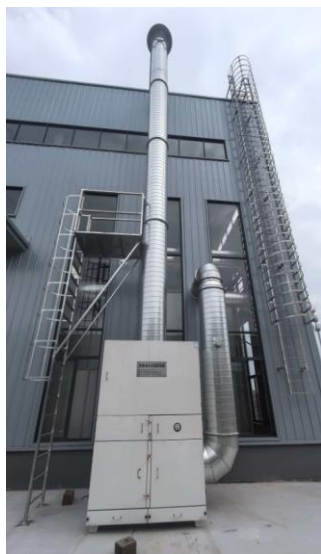
图 4.1-1 焊接废气处理装置 TA001 及排气筒 DA001
