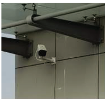
厂区门口摄像头
