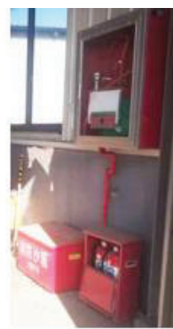
室内消防栓、灭火器
