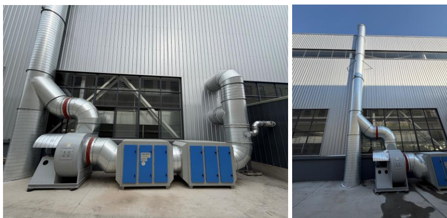
图 4.1-2 喷漆、晾干、危废库废气“滤棉过滤+两级活性炭吸附”装置及排气筒
