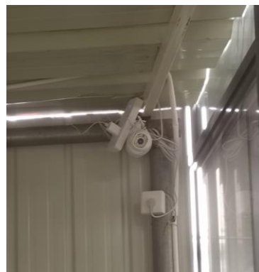
危废库内摄像头
