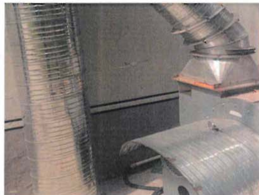
环保设施发生故障
