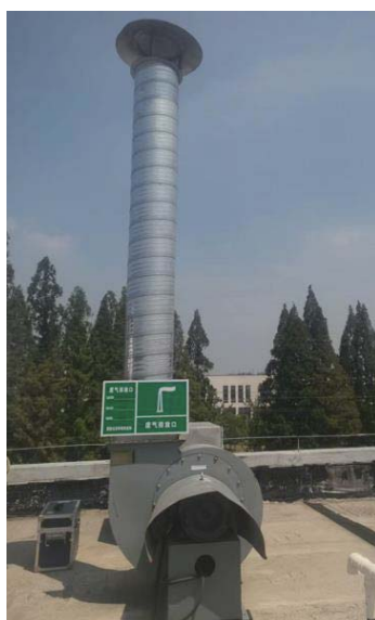
图 4.1-2 静电式油烟净化装置及排气筒 DA002
