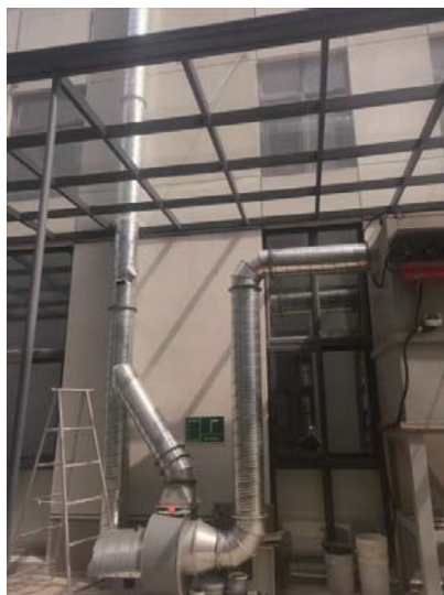
图 4.1-1 布袋除尘器及排气筒 DA001
