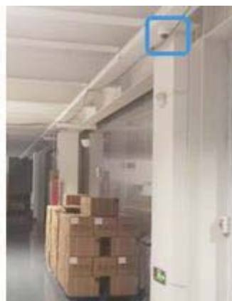
危废贮存点摄像头
