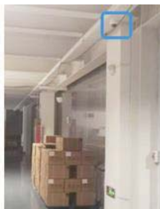
危废贮存点摄像头
